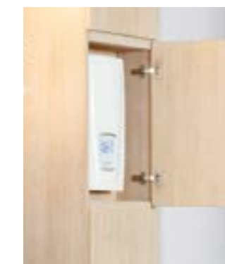
Dans un meuble de salle de bains
